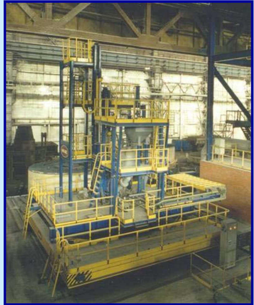
Участок вакуумной обработки стали на базе парожеткорного насоса
